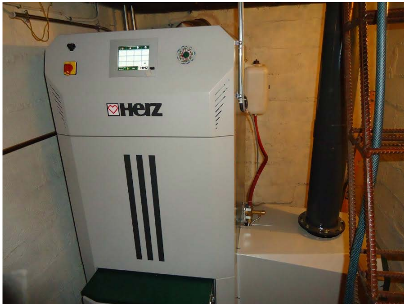
Lämpökeskuksen uusi kattila. Kuva: Matti Messala.
