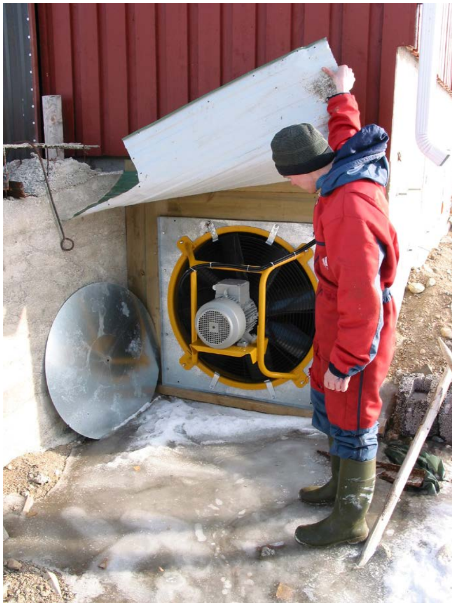
Lämpökeskuksen hakevaraston kuivausilmapuhallin.
